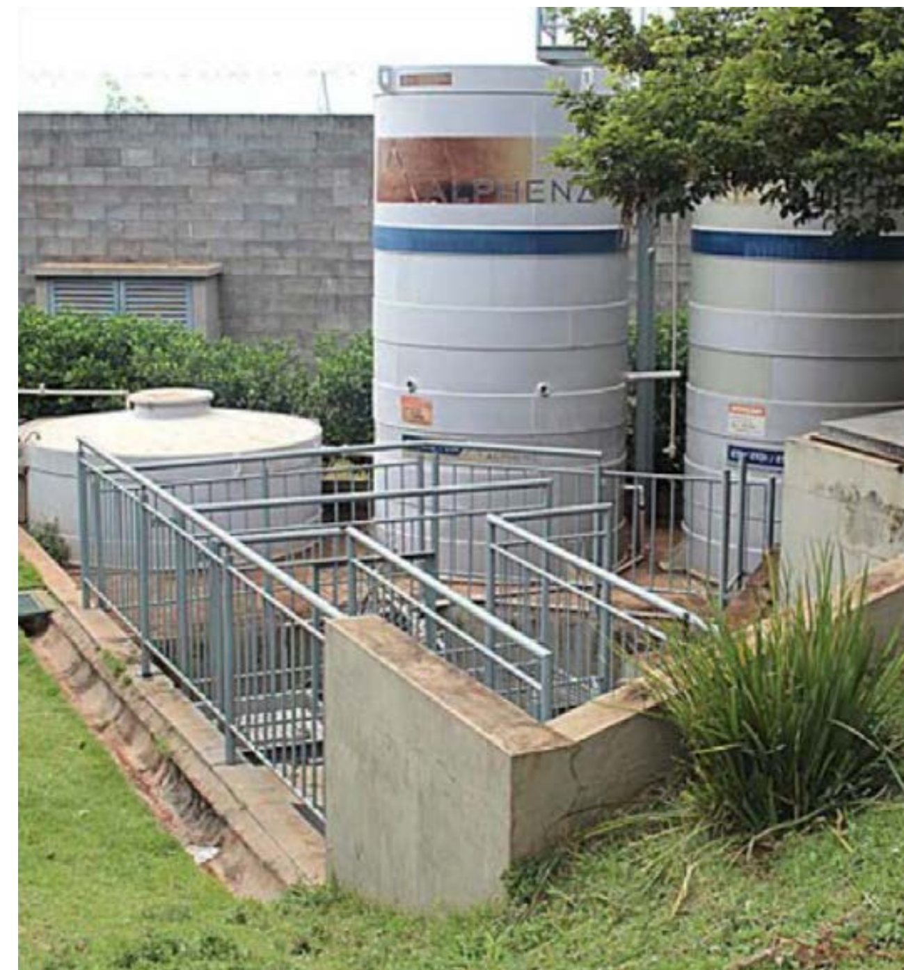
Estação de tratamento de efluentes (ETE) da fábrica BYD em Campinas (SP)
