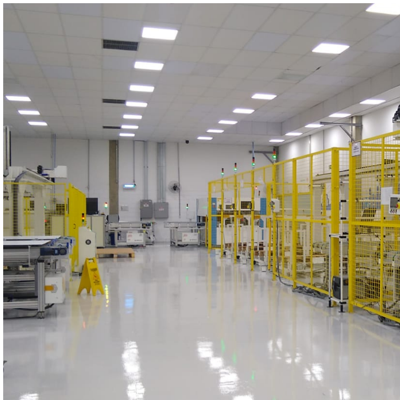
Lâmpadas de LED instaladas na fábrica da BYD Energy em Campinas (SP)
