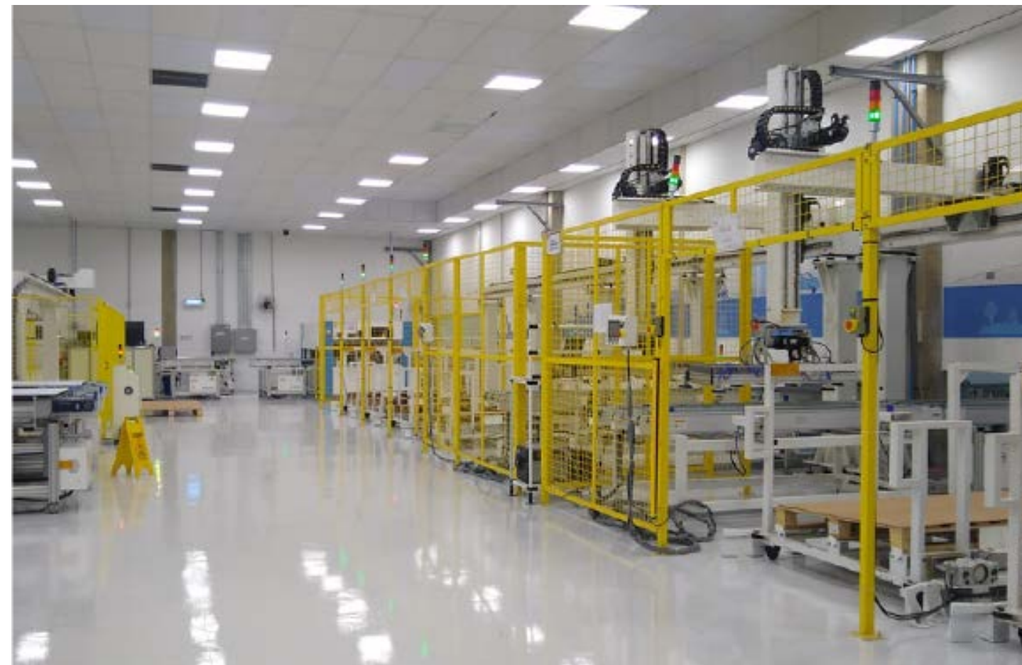
Lâmpadas de LED instaladas na fábrica da BYD Energy em Campinas (SP)
