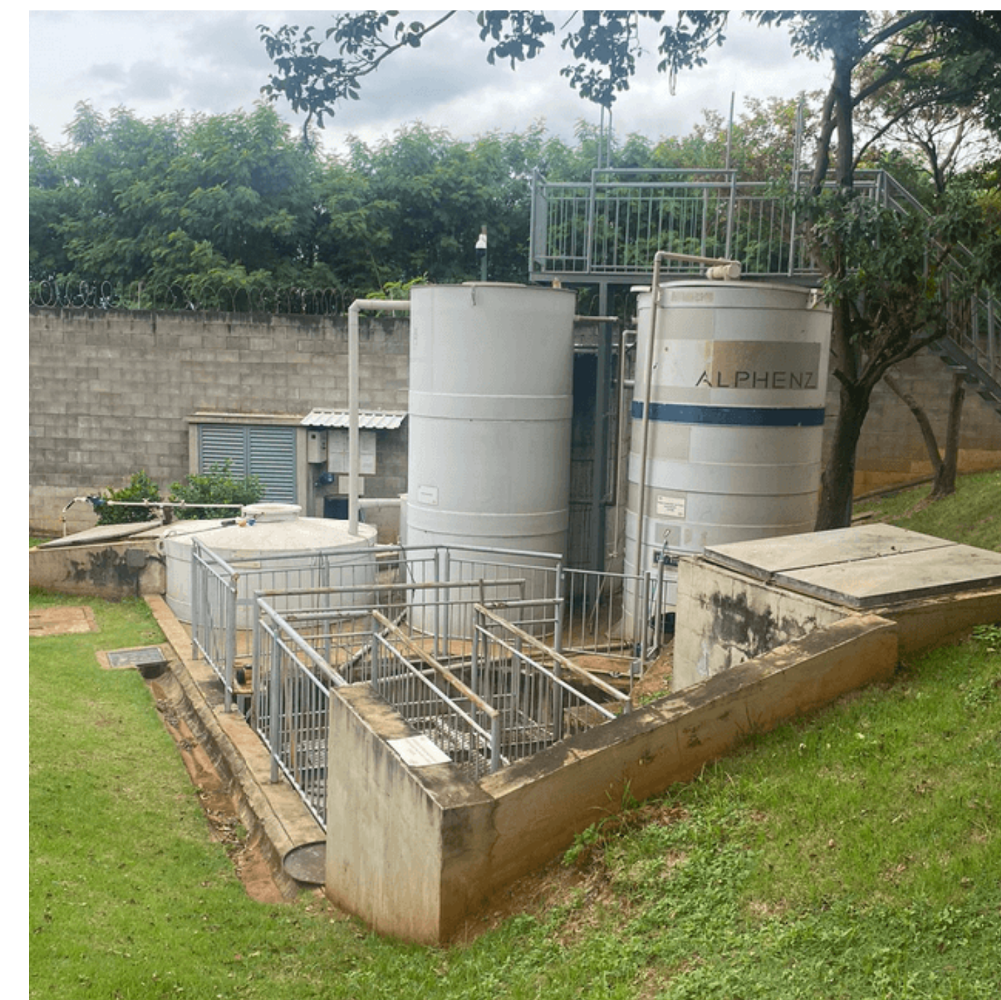
Estação de tratamento de efluentes (ETE) da fábrica BYD em Campinas (SP)
